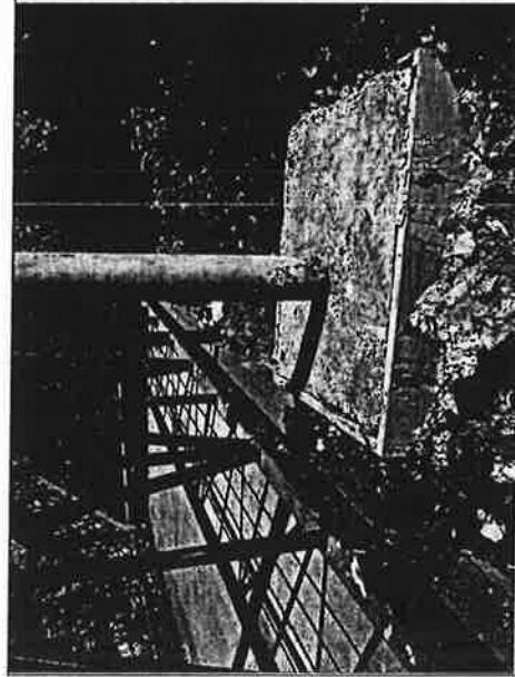
Fotografía N° 33: Moldaje presente en poste de iluminación, de la acera aterrazada del sector reloj.
